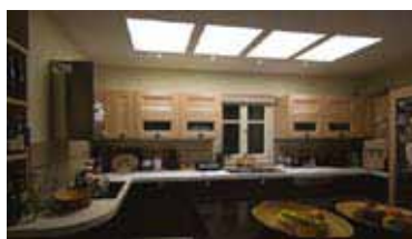
Φωτισμός τεχνολογίας LED
